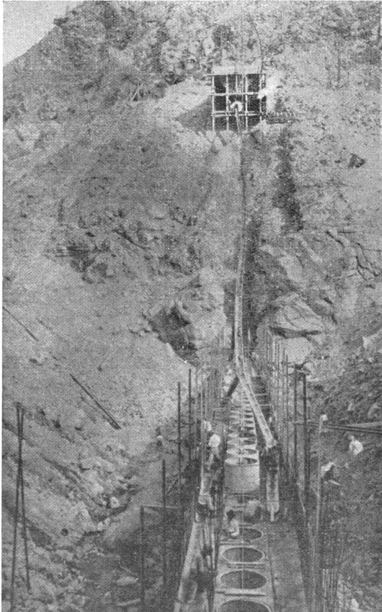
FIG. 7. — Vista general de la Quebrada La Rioja en el Río los Sauces donde se está construyendo el muro de embalse en cemento armado.
